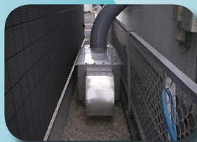
公害防止プラント 設計 施工
